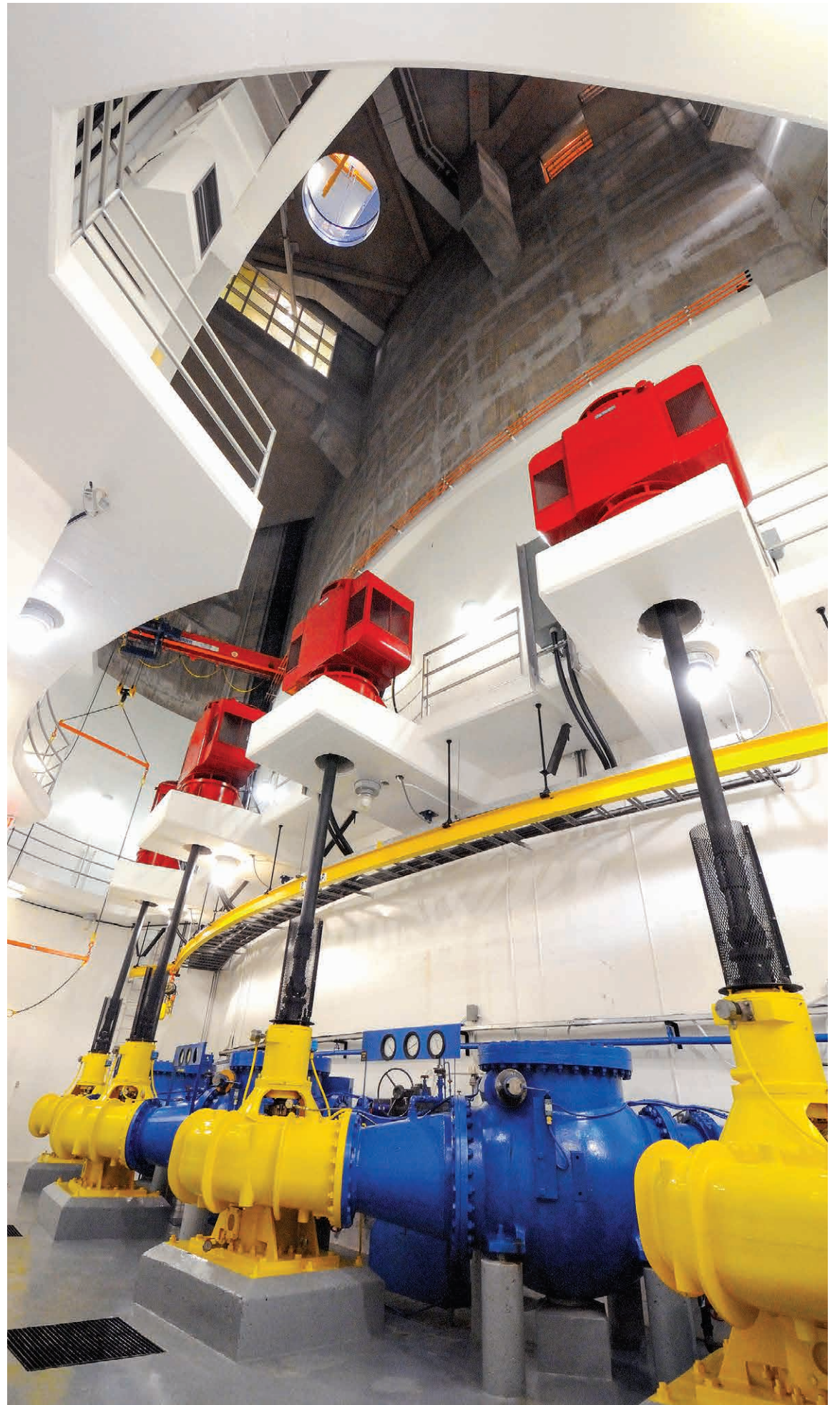
À l'intérieur de l'usine de traitement des eaux usées à Riverview.
