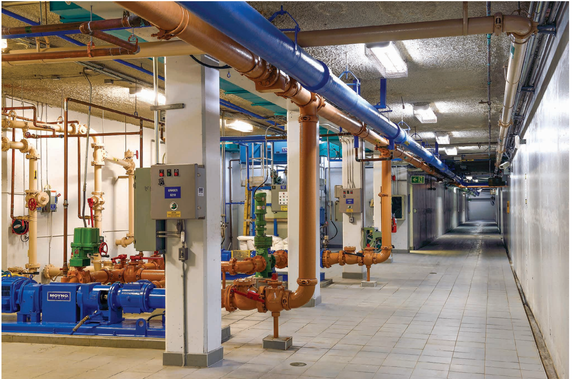
À l'intérieur de l'usine de traitement des eaux usées à Riverview.
